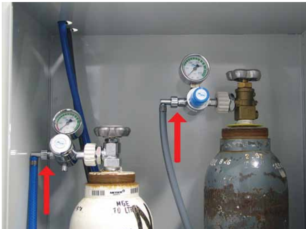
Slika 2: Osrednja preskrbovalna enota kisika in dušikovega oksidula. Puščici prikazujeta plinski spojki, ki povezujeta jeklenki s cevmi plinske napeljave.
