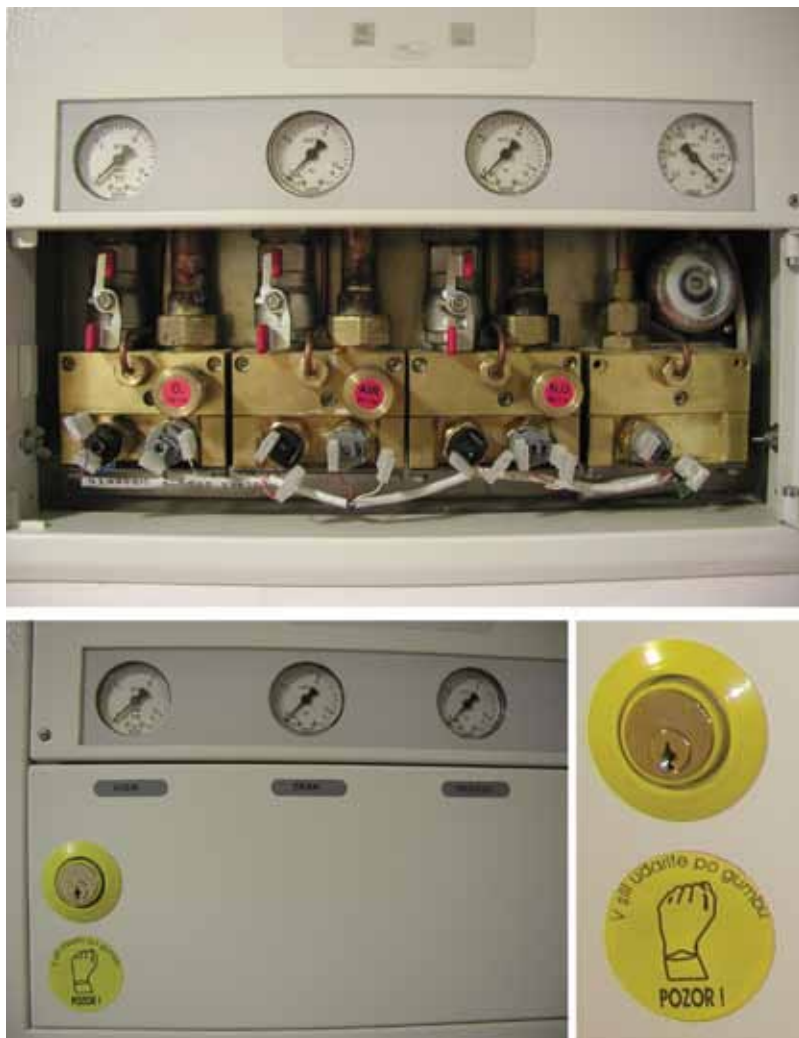
Slika 5: Omarica s kontrolno-zapornimi ventili za zasilno zaporo oksidantov (zgoraj – odprta, spodaj – zaprta).
